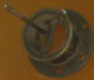
Отверстие в воздушной заслонке
